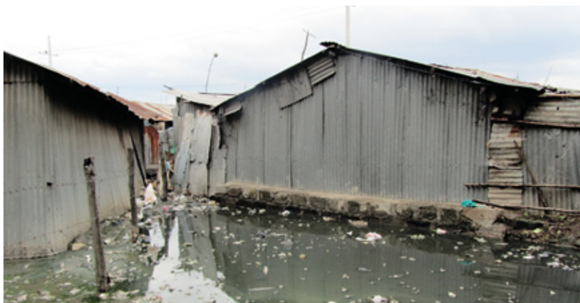
Offener Abwasserkanal im Mukuru Slum, Nairobi, Kenia
